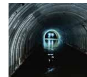
Die Experten überprüfen eine stillgelegte Wasserhebeanlage, die in einem überfluteten Bereich liegt.
