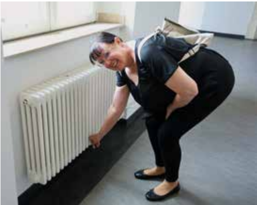
Alles staubfrei? Ruth Sals prüft nach und fährt mit dem Finger durch die Zwischenräume der Heizkörper.
